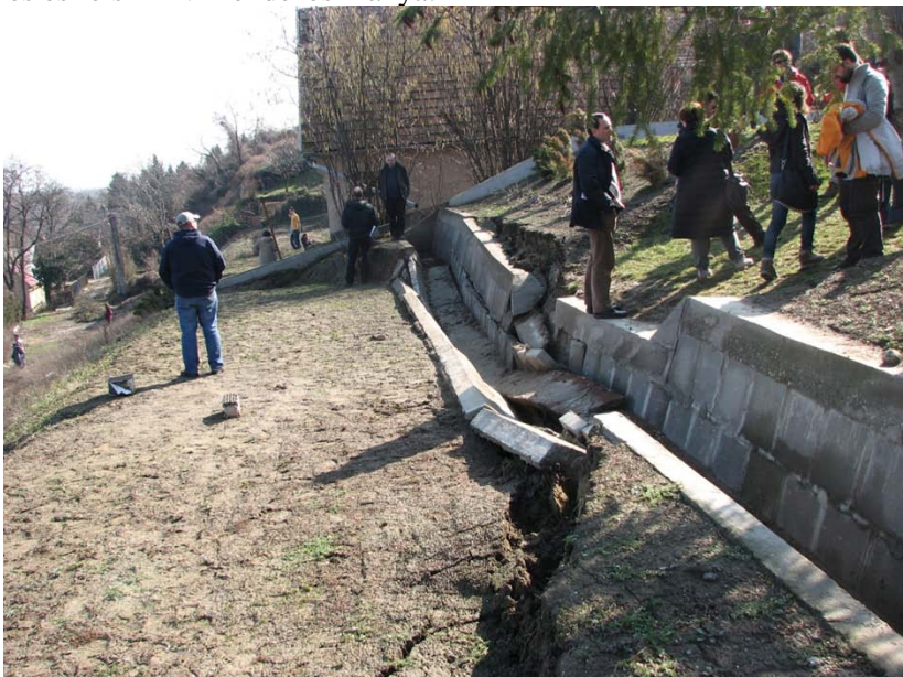
4. ábra. A műszakilag nem megfelelő „helyreállítást” követően 2013. februárban a korábbival megegyező helyen jelent meg a csúszólap felszíni kimetsződése
