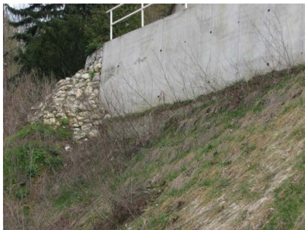
1. ábra. Támfal alatti megmozdult földtömeg (Slided rock mass below a retaining wall)
