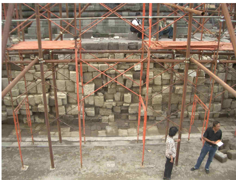
11. ábra. A Visnu-szentély alsó részéről lebontották a külső, faragott kőburkolatot (2008. május állapot). Láthatóvá vált az építmény magja: fehér színű, puha vulkáni tufa. A díszes, aprólékos faragásokat egy sötét, keményebb, az időjárásnak ellenálló vulkáni kőzetben formálták meg. Habarcsot nem alkalmaztak az építésnél.
