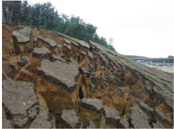
10. ábra: Blokkokban álló lecsúszott földtömeg
