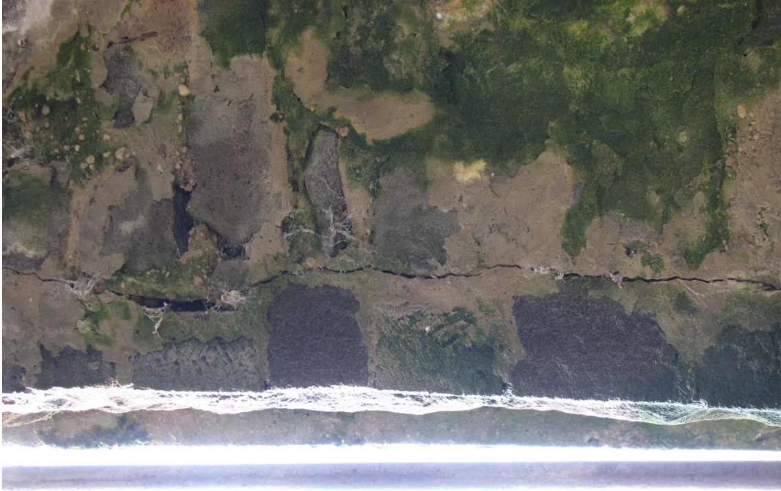
4. ábra. Homlokfal elválása
