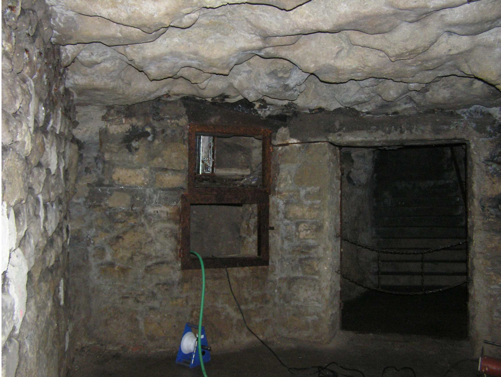
3. kép. Mérőórák kút szivattyúzása
