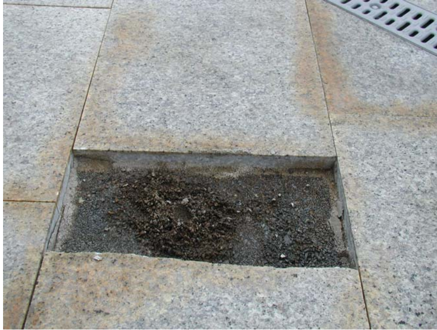
10. ábra. A megbontott burkolati részen jól látható, hogy a fugázó homokban a kapillaritás eredményezi a szennyező vasoxidos víz felszínre kerülését, ahol abból a kiszáradás következtében a szennyező anyag kiválik és a kőlap széleit elszínezi.
