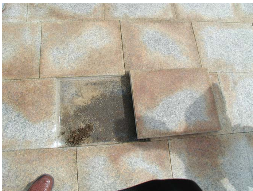
7. ábra. A gránit burkolólap alatti ágyazat részben átnedvesedett, részben már kiszáradt. A barnás-vörösen elszíneződött ágyazati részekből a kapillaritás a felszínre viszi a vasoxidot, ahol az kiválik, majd a csapadékvíz szétteríti.
